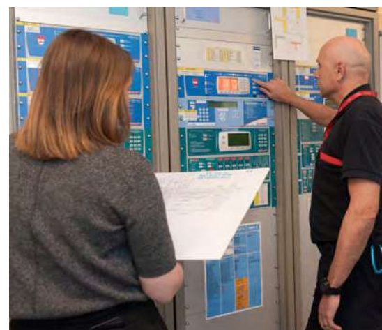
▲ Avec un pompier de garde, Camille Guégan-Marcelot vérifie le fonctionnement des baies du système de sécurité incendie. Récemment renouvelé, il centralise et localise les alarmes incendie.
