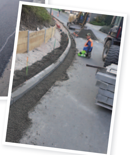
Mise en sécurité du virage rue des Deux Opens : Ducrocq TP et Département Coût : 48 910.80 € - Coût Commune : 48 910,80€
